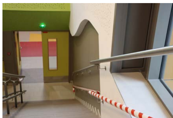
Présence d'une deuxième main courante à hauteur d'élève (Villeneuve-d'Ascq)
