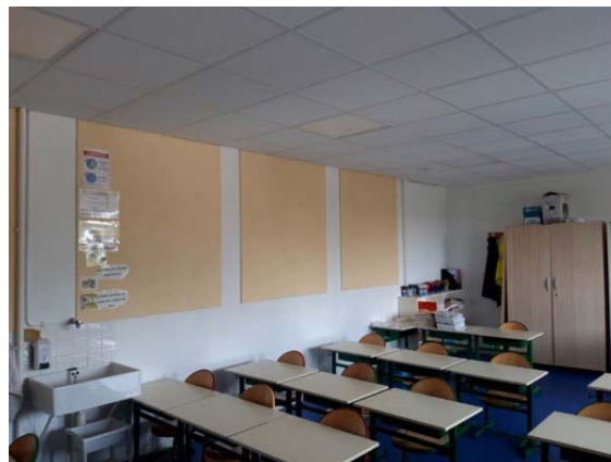
Panneaux acoustiques installés sur les murs d'une salle de classe (La Roche-sur-Yon)
